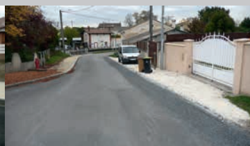
Rue de la Racace près du passage à niveau (création du trottoir de droite reprise de rive avec pose de bordures fran- chissables)
