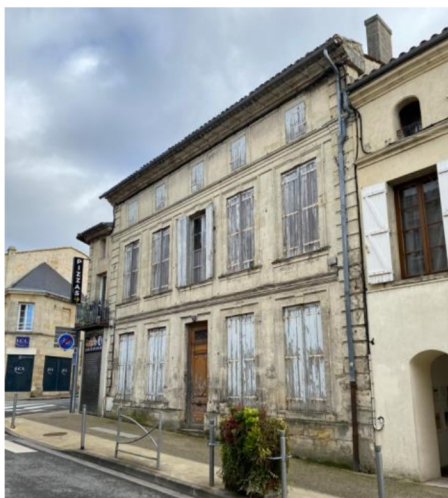
Façade dégradée // crédit photo MERCAT
